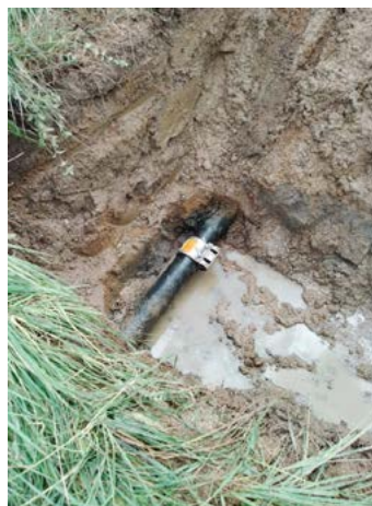
Fuite sur canalisation adduction « Chabroulière »
