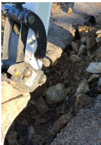
Recherche de fuite chemin de Nadal
